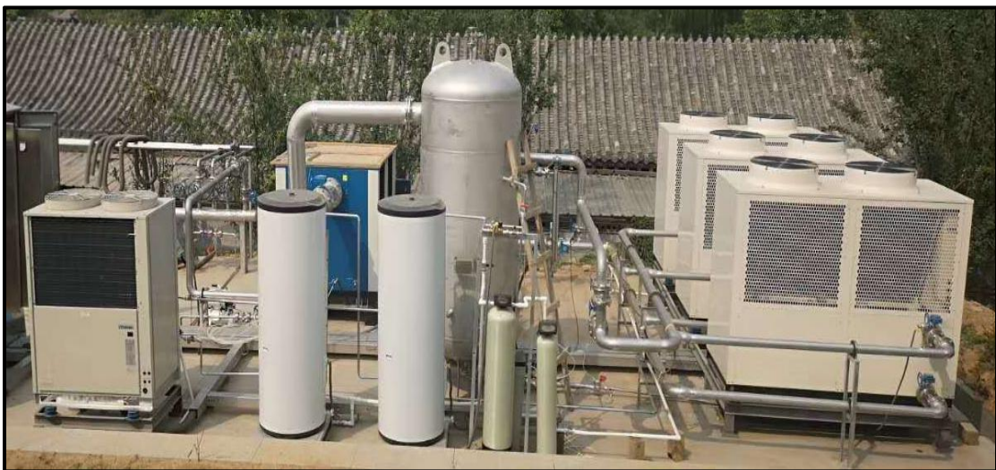
山东济南力诺科技园蒸汽供应项目
